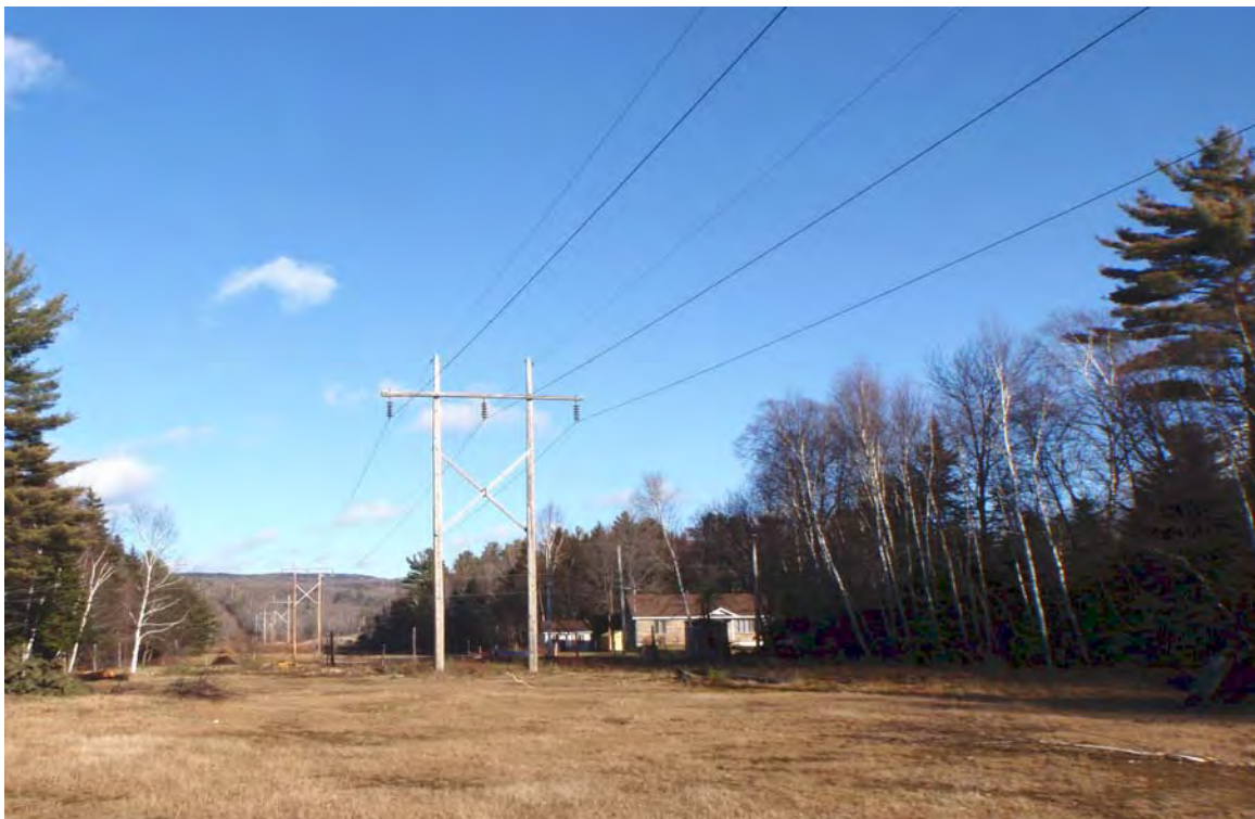
Ligne de transmission à 69 kV, vue vers le nord-est à partir du chemin d'accès au site récréo-touristique Canyon Ste-Anne. À cet endroit la ligne est implantée sur la terrasse à 130 m.
