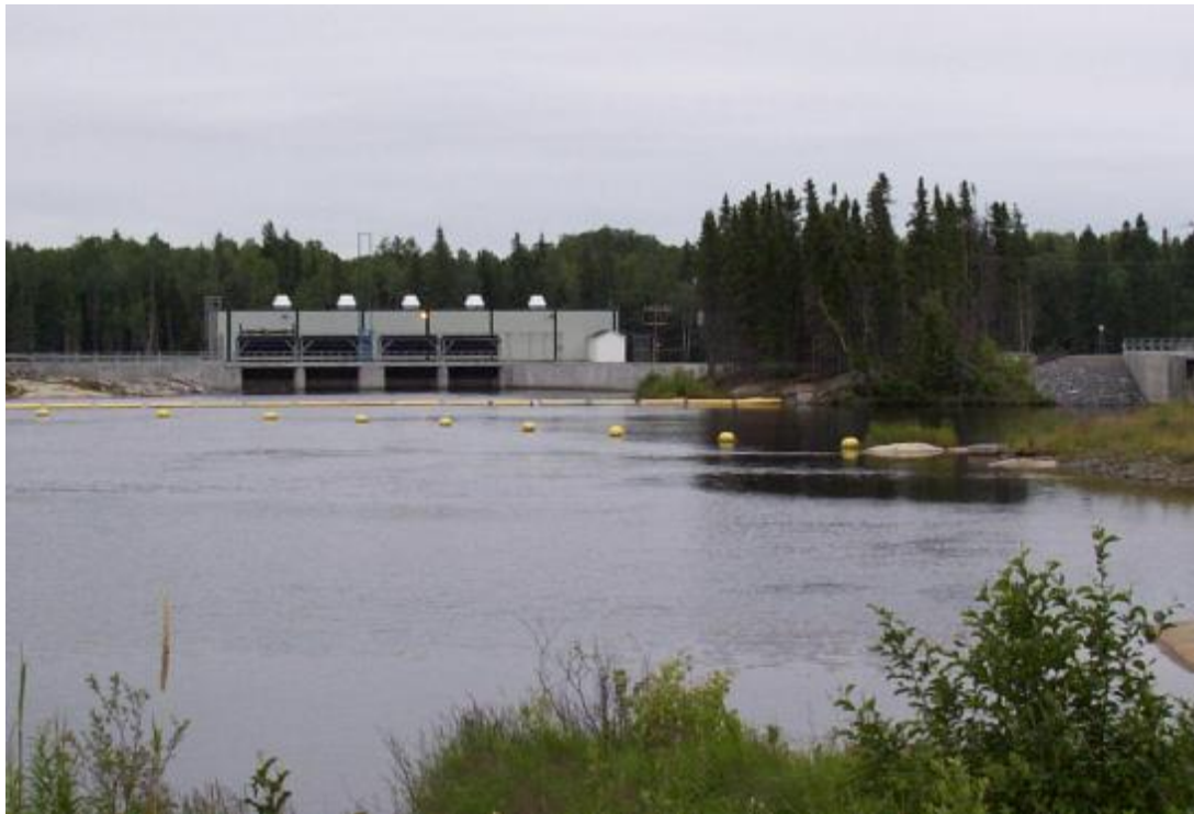
Vue du barrage et de la centrale Minashtuk sur la rivière Mistassibi tout près de la Ville de Dolbeau-Mistassini.
