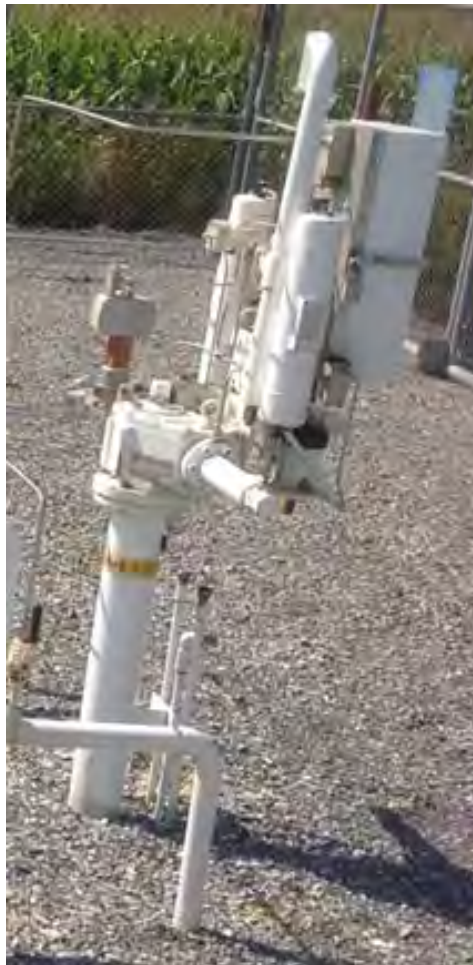
Photo 1 Aménagement typique d'une vanne de sectionnement
