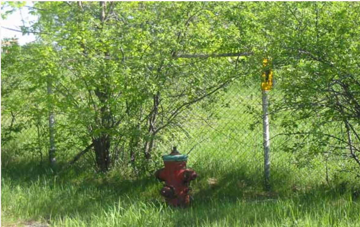
Borne d'incendie du secteur
