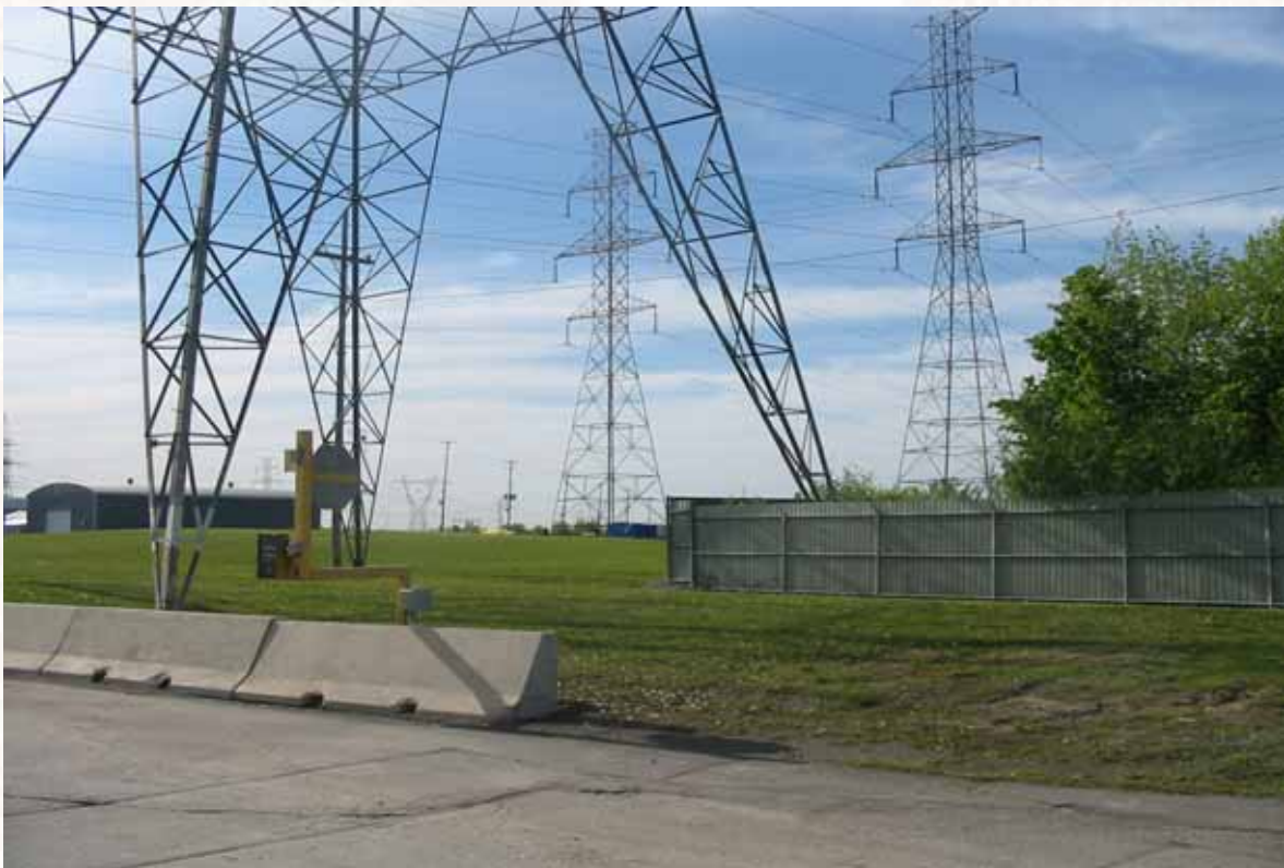
Poste de détente (B)
