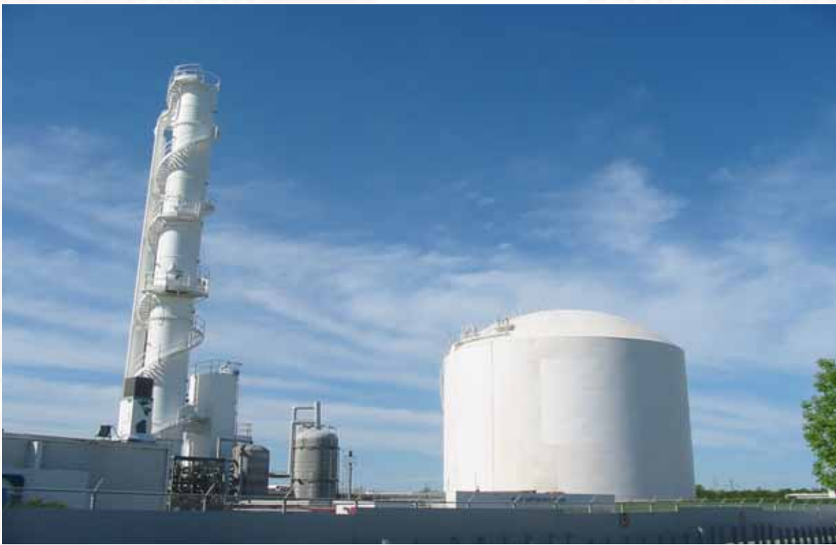
Réservoir Gaz métropolitain (C)
