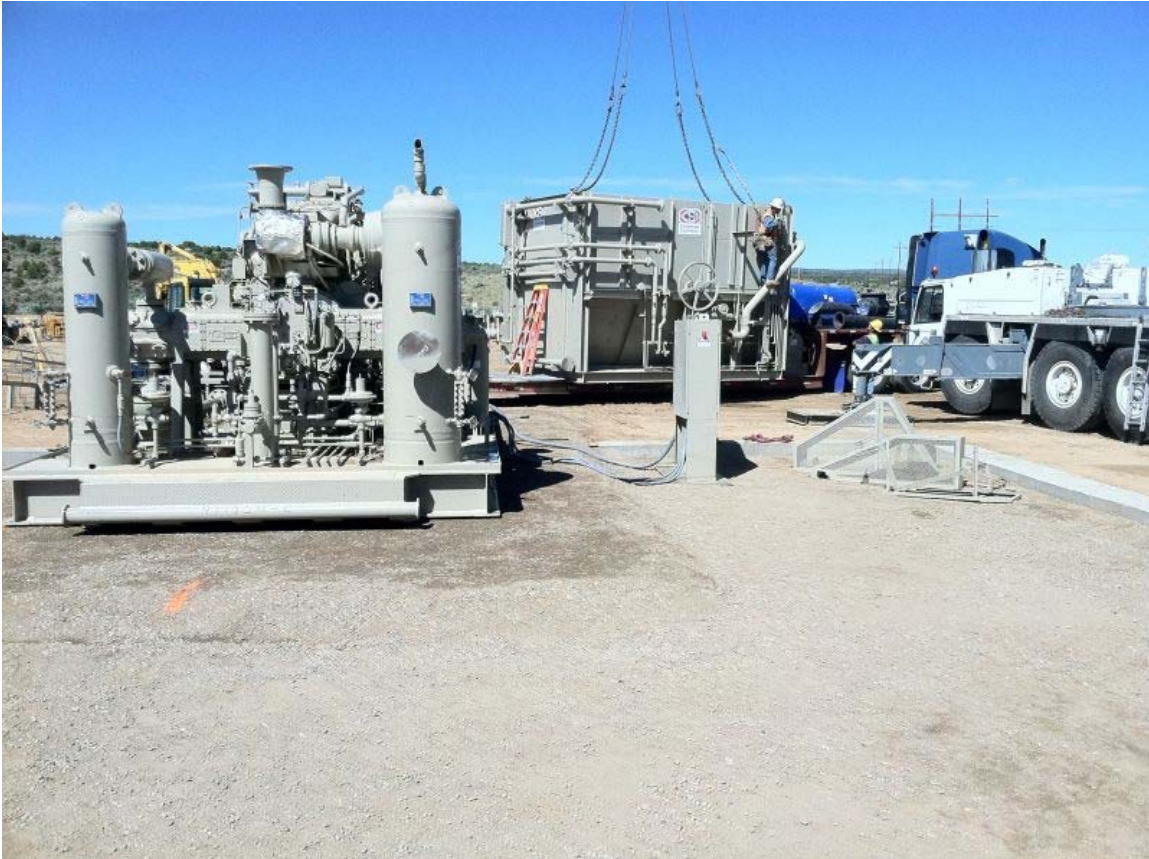
Image 11. Arrivée par camion des composantes nécessaires à l'assemblage d'une station de compression, Meeker, Colorado
