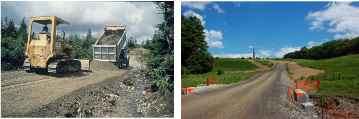
Figure 2 : Construction de la route d'accès (Sources : gauche : Newfoundland Department of Natural Resources, droite : SGEIS 2009)
