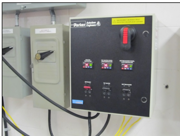
Figure 4 Contrôleur de température
