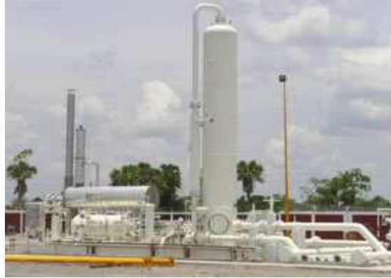
Figure 14 : Unité de déshydratation des gaz.
