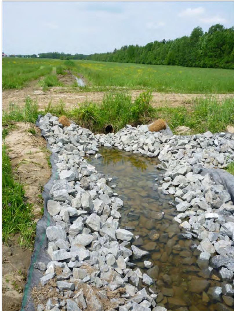
BASSIN DE SÉDIMENTATION AUX ABORDS DU SITE À FORTIERVILLE. (2010)
