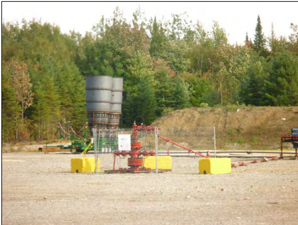
UNITÉ D'INCINÉRATION DE GAZ NATUREL MOBILISÉE SUR LE SITE GENTILLY N° 2 DANS LE CADRE DES ESSAIS DE PRODUCTION. (2010)
