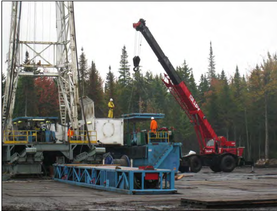
MONTAGE DE LA FOREUSE AKITA N° 40 À SAINT-ÉDOUARD-DE-LOTBINIÈRE, À L'AIDE D'UNE GRUE GUAY. (2009)
