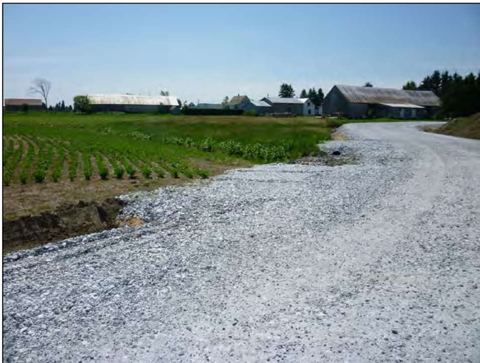
PONCEAUX AMÉNAGÉS DANS LE FOSSÉ DE DRAINAGE DU CHEMIN D'ACCÈS AU SITE À SAINTE-GERTRUDE AFIN DE FACILITER L'UTILISATION DE LA MACHINERIE AGRICOLE. (2010)
