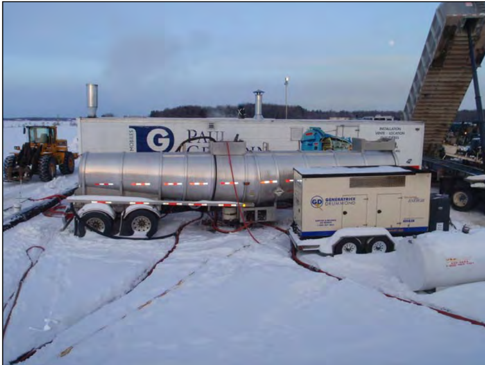
CHAUDIÈRE DE LA COMPAGNIE ATELIERS MOBILES PAUL GRONDIN MOBILISÉE SUR LE SITE LA VISITATION N° 1. (2008)
