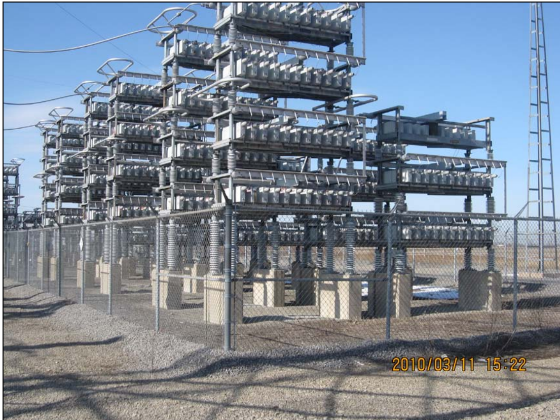
Photo QC-70-1 : Batterie de condensateurs à 315 kV de 150 Mvar
