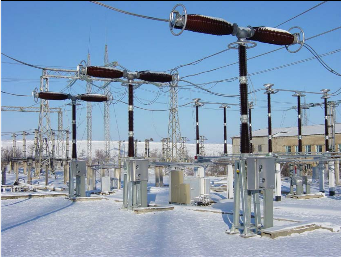
Photo QC-70-2 : Disjoncteur triphasé à haute tension isolé au gaz SF 6
