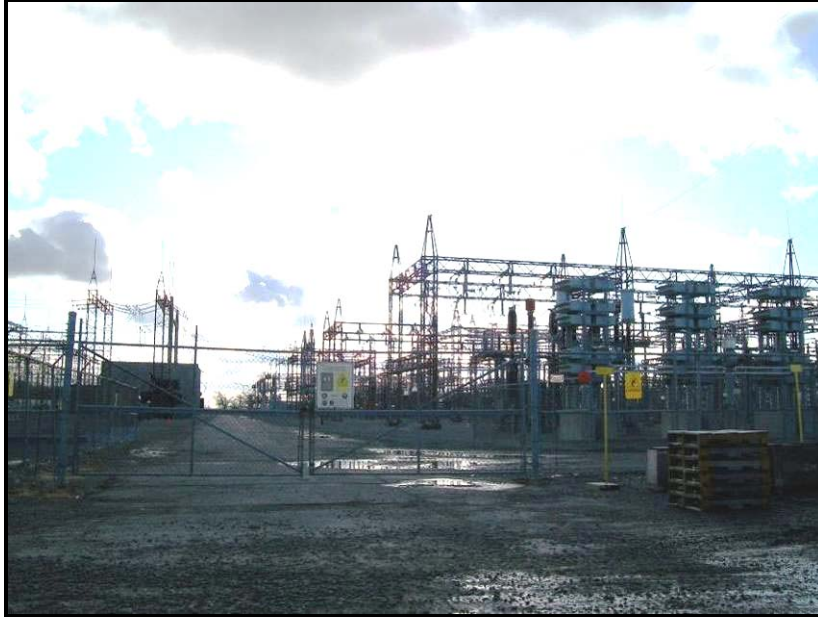
Photo n° 3 (2009-12-04) : Vue vers le sud du poste Bout-de-l'Île situé du côté sud-est du site à l'étude.
