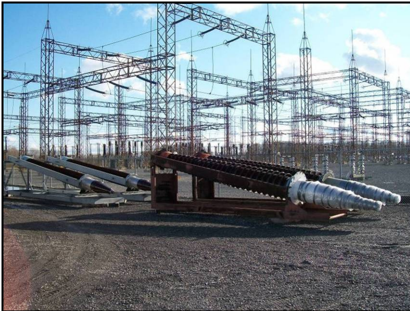
Photo n° 82 (2009-12-04) : Entreposage de traversées de grandes dimensions dans la zone d'entreposage n° 97.
