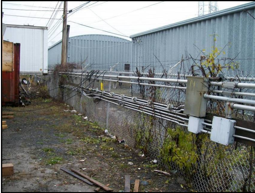
Photo n° 107 (2009-12-03) : Conduites électriques installées sur la clôture située près de la zone d'entreposage n° 98.
