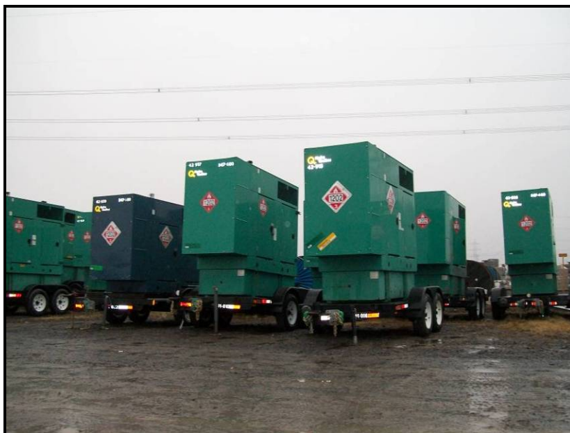
Photo n° 72 (2009-12-03) : Génératrices mobiles stationnées au nord du bâtiment des génératrices.
