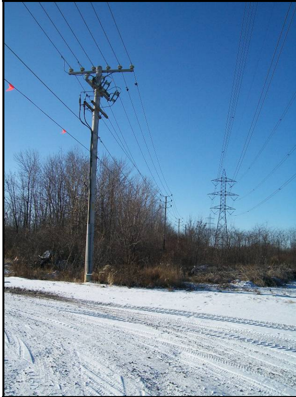
Photo n° 111 (2009-12-08) : Poteaux en bois traité et pylône en métal en bordure nord de la partie boisée du secteur ouest.
