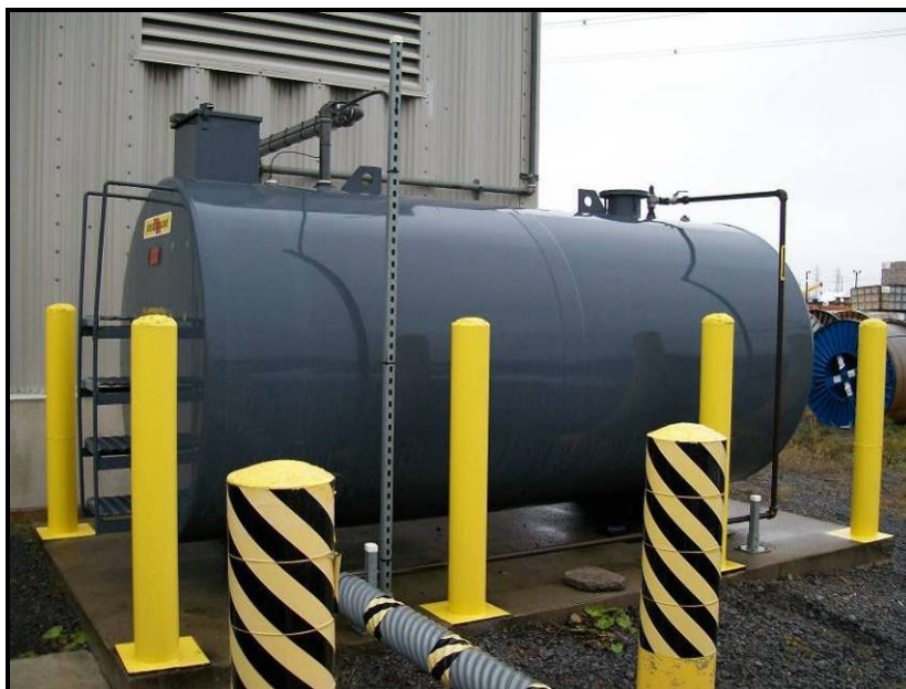
Photo n° 103 (2009-12-03) : Réservoir (D) du poste de distribution de diesel situé au nord du bâtiment des génératrices.
