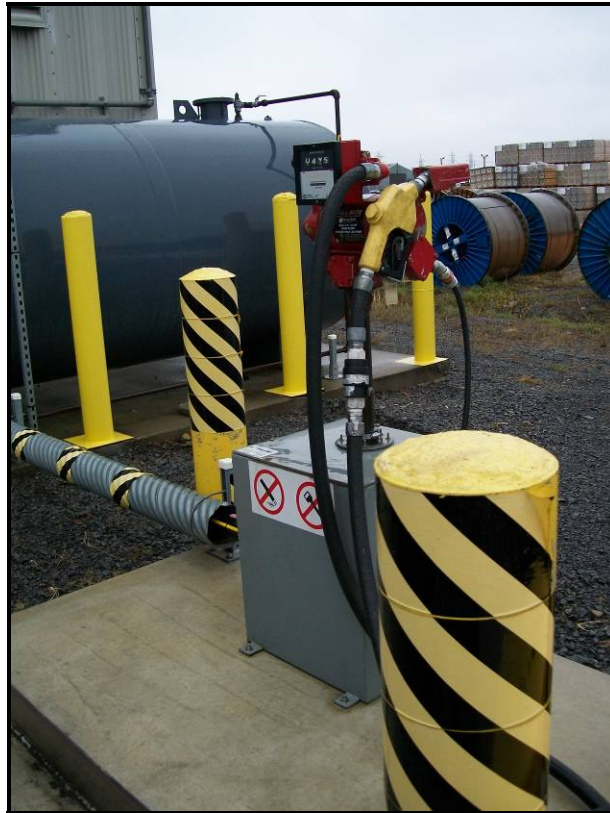
Photo n° 101 (2009-12-03) : Pompe distributrice pour le poste de distribution de diesel situé au nord du bâtiment des génératrices.
