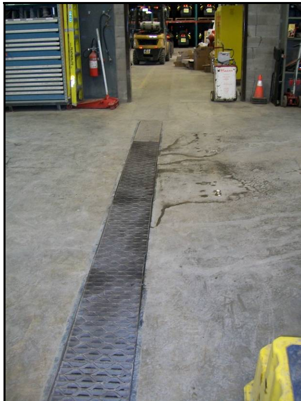
Photo n° 10 (2009-12-01) : Drain dans le plancher du bâtiment B.
