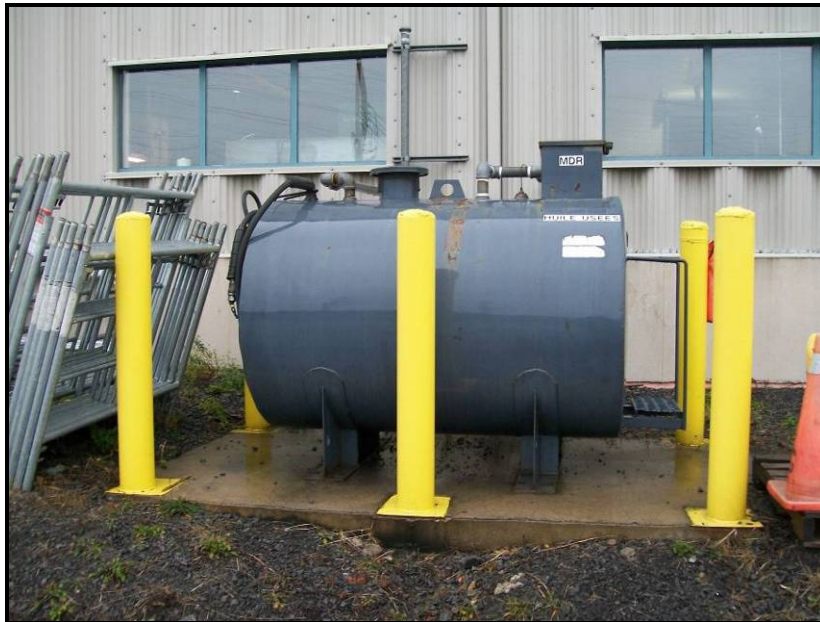
Photo n° 105 (3 décembre 2009) : Réservoir d'huiles usées (G) à l'est du bâtiment des génératrices.
