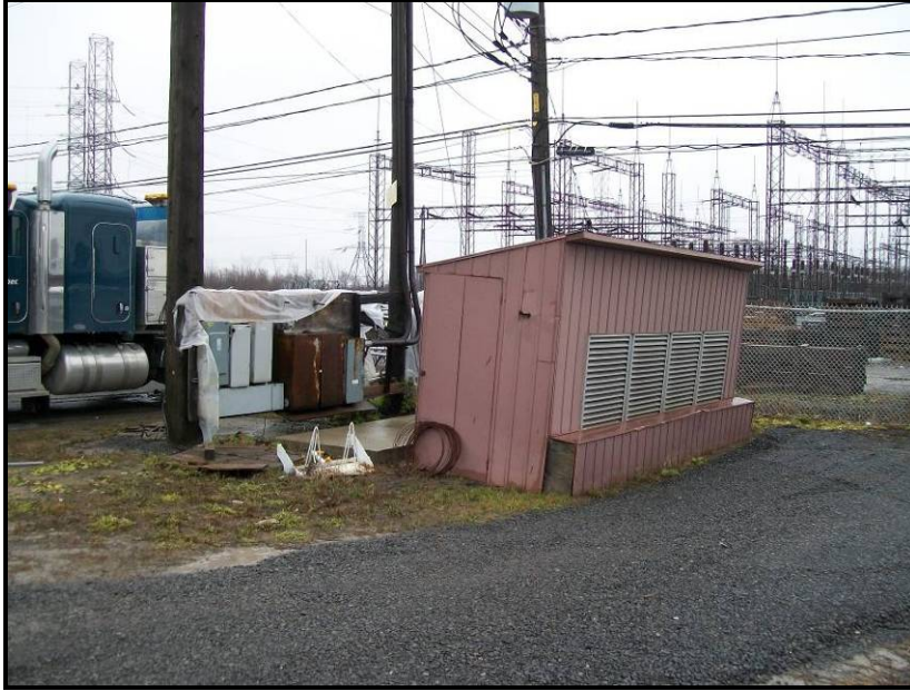
Photo n° 109 (2000-12-03) : Petit abri en métal pour de l'équipement électrique.
