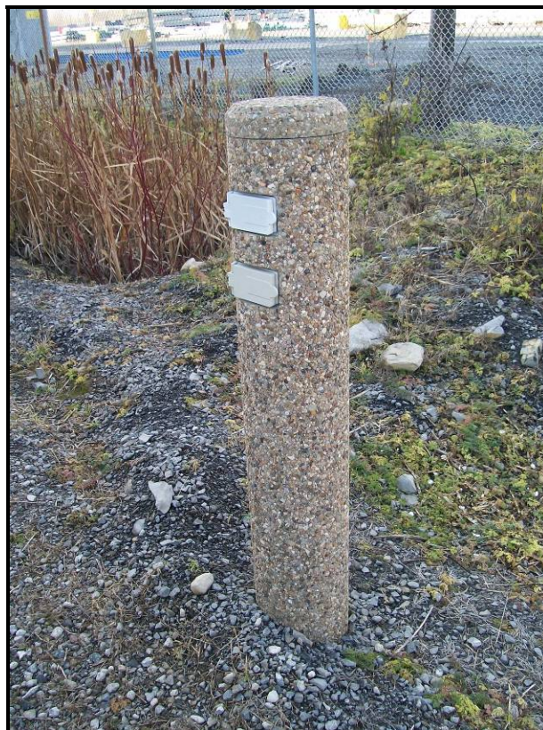
Photo n° 108 (2009-12-04) : Borne en béton comportant des prises électriques.
