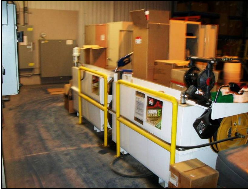
Photo n° 57 (2009-12-011) : Réservoirs (2) de diesel avec pompes distributrices dans la partie nord du bâtiment des génératrices.
