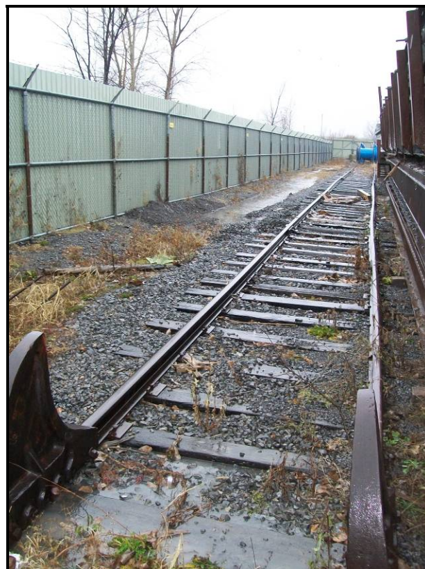
Photo n° 113 (2009-12-03) : Voie ferrée située dans la partie nord de la zone d'entreposage n° 95.
