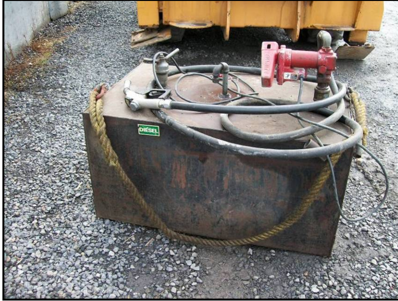
Photo n° 106 (2009-12-01) : Réservoir portatif de diesel (I) près du bâtiment P.
