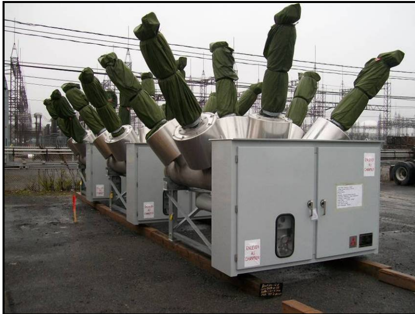
Photo n° 80 (2009-12-03) : Entreposage de disjoncteurs de grandes dimensions dans la zone d'entreposage n° 98.
