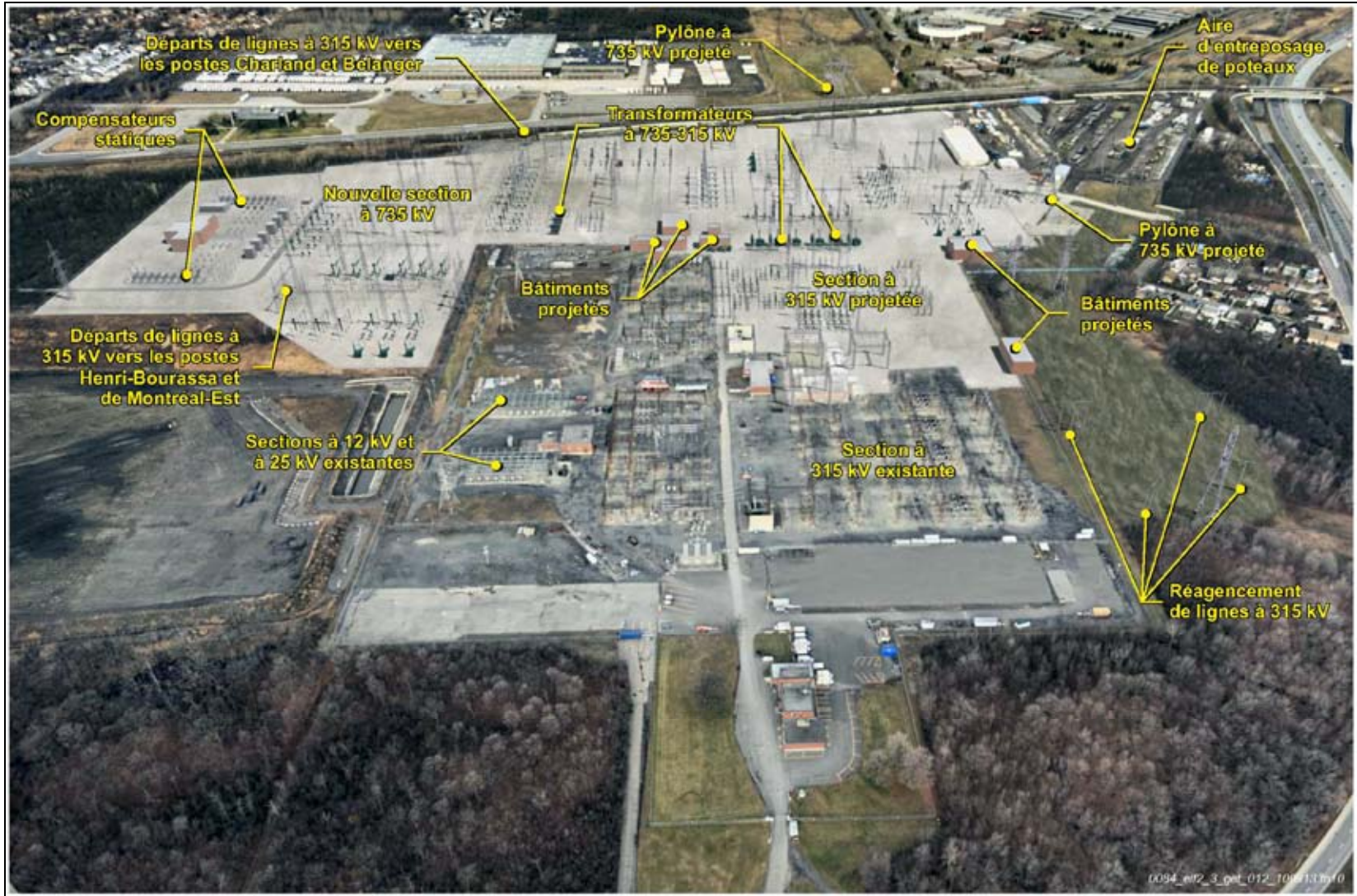
Figure 2-3 : Simulation visuelle du poste du Bout-de-l'Île à l'étape finale d'ajout d'équipements à 735 kV
