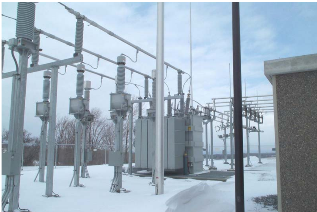
Poste et transformateurs
