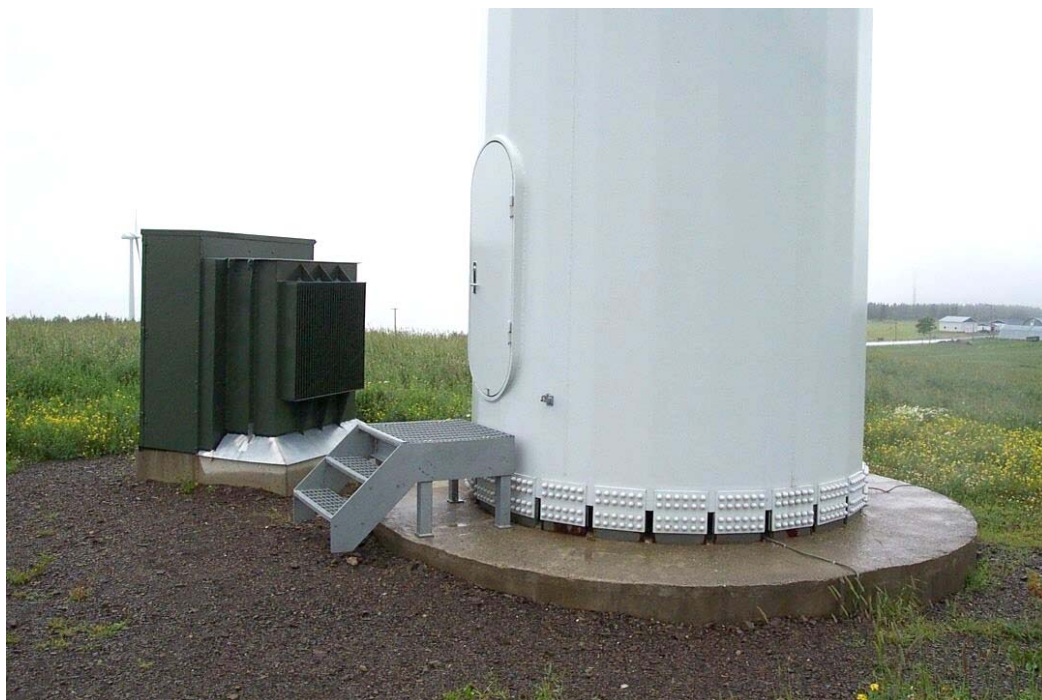
Base d'éolienne et transformateur
