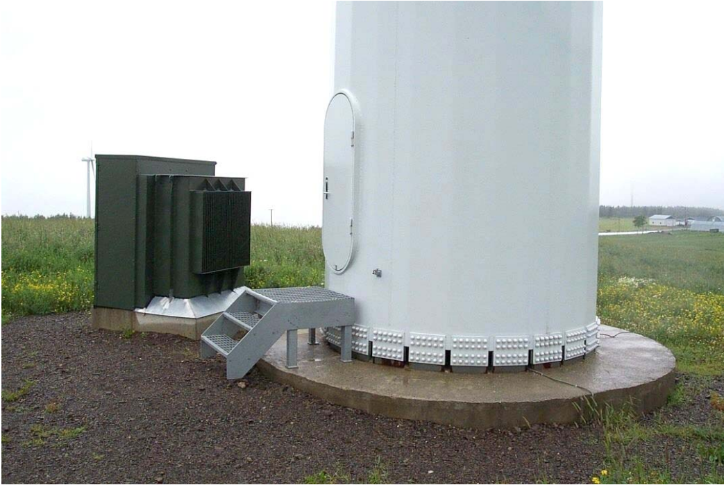
Base d'éolienne et transformateur
