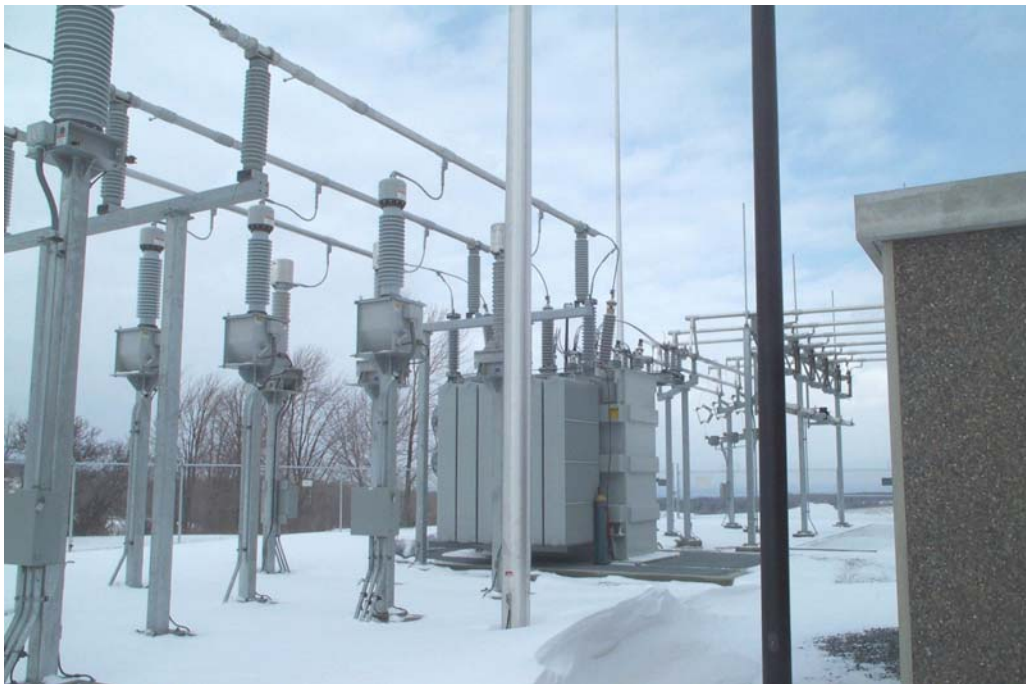
Poste et transformateurs
