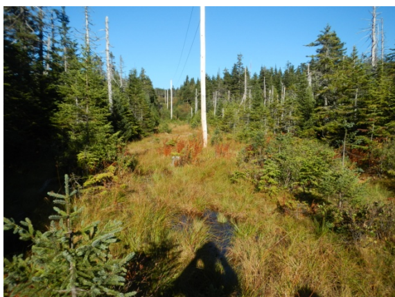
Photo 7. Milieu humide N° 2 – Ligne de distribution d'électricité
