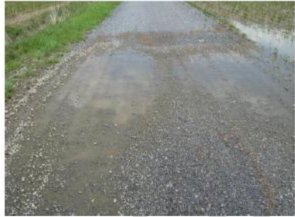
Mauvaise condition de surface de la piste Sud vers le Nord
