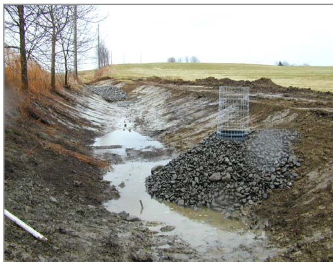
Grille aménagée sur un puisard
