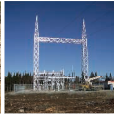
Poste de raccordement au réseau haute tension d'Hydro-Québec
