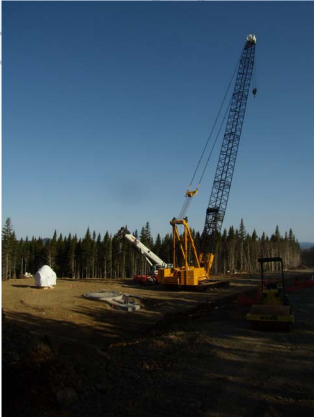
Parc éolien de Montagne Sèche
