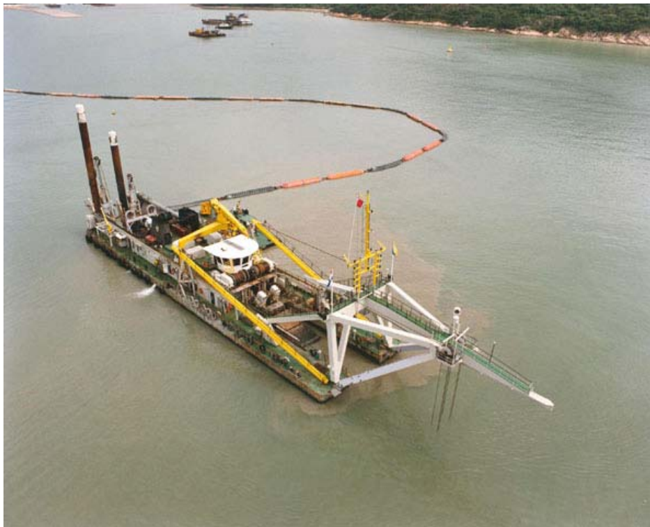
Figure 9.1 Drague hydraulique (type « suceuse-refouleuse » ou « Cutter suction ») pompant du sédiment (par les tuyaux situés à l'arrière-plan)
