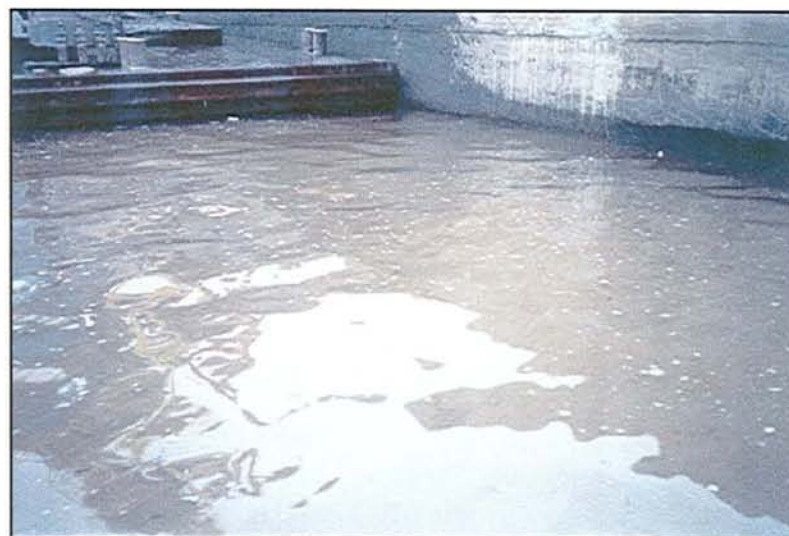
8. Présence de débris végétaux à la surface de l'eau près de la zone de transbordement
