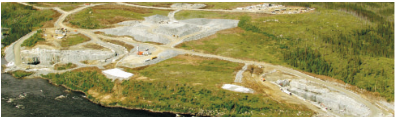
Travaux de construction de la galerie de dérivation provisoire, sur le site du projet de l'Eastmain-1
