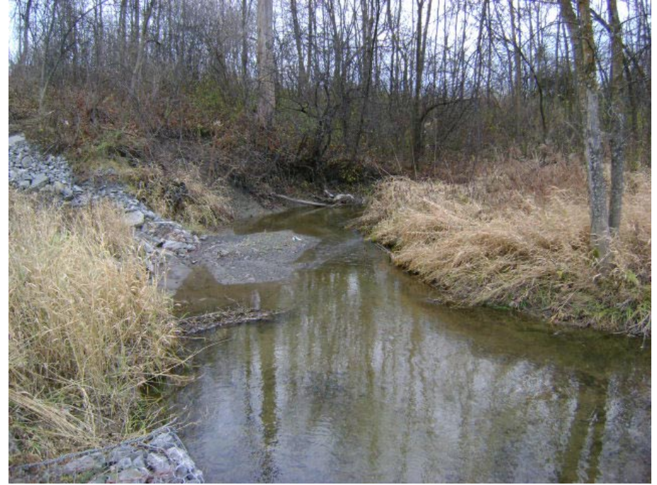
Photographie #4 Vue en amont du chemin Pink du ruisseau des Fées (CD2) .
