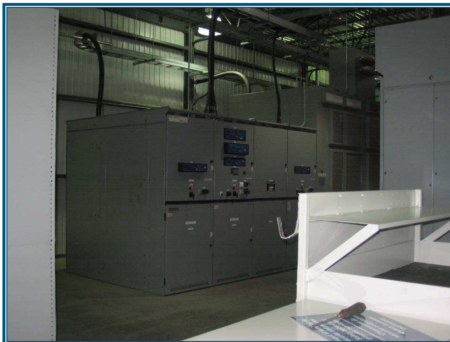
Photo 8 : Infrastructures de production d'électricité.
