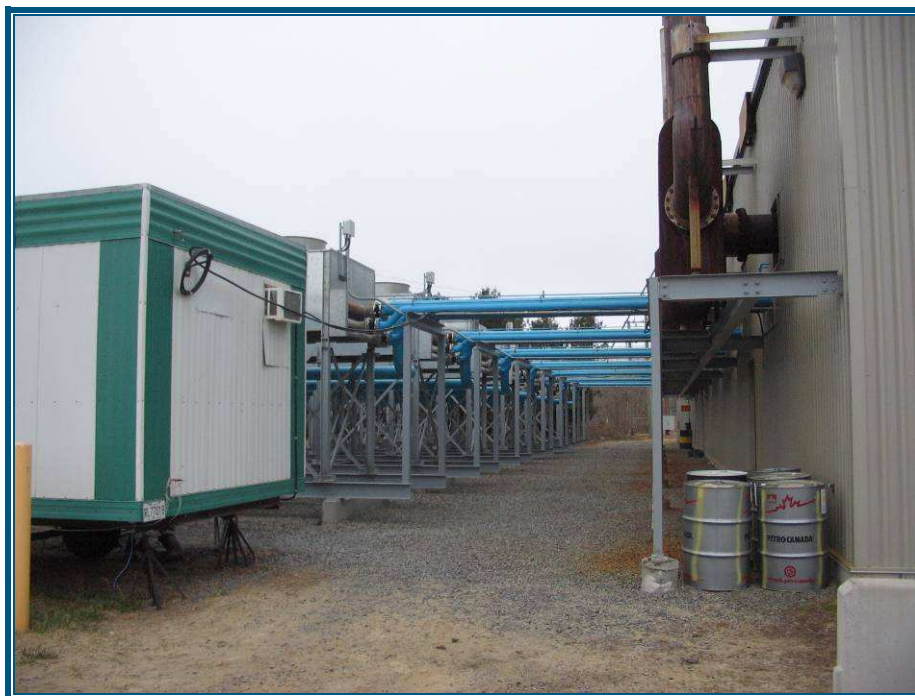
Photo 7 : Système de refroidissement des moteurs au glycol et cheminées.
