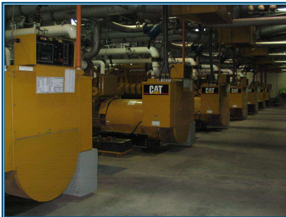
Photo 6 : Moteurs à combustion interne Caterpillar.
