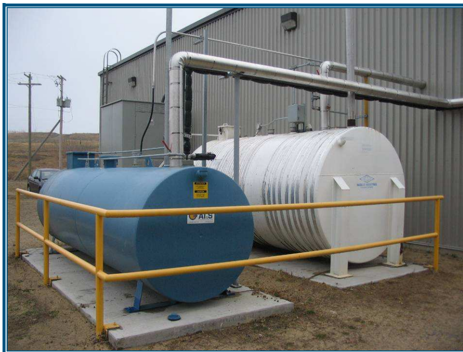
Photo 9 : Réservoir d'huile usée à gauche et réservoir d'huile de lubrification neuve à droite.
