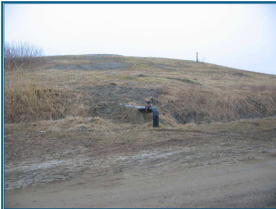
Photo 2 : Conduite de biogaz.
