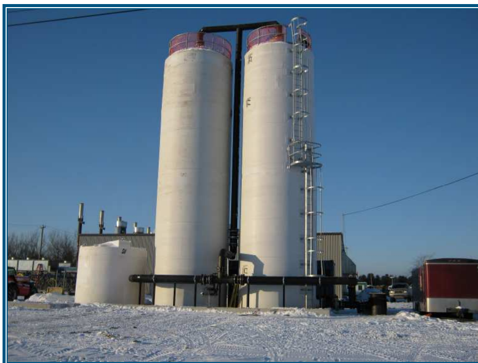
Photo 10 : Unité de désulfuration.
