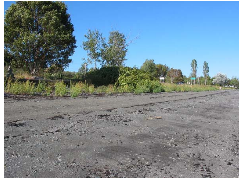
Photo 20 : Érosion plus faible entre les ch : 11+860 et 12+030.
