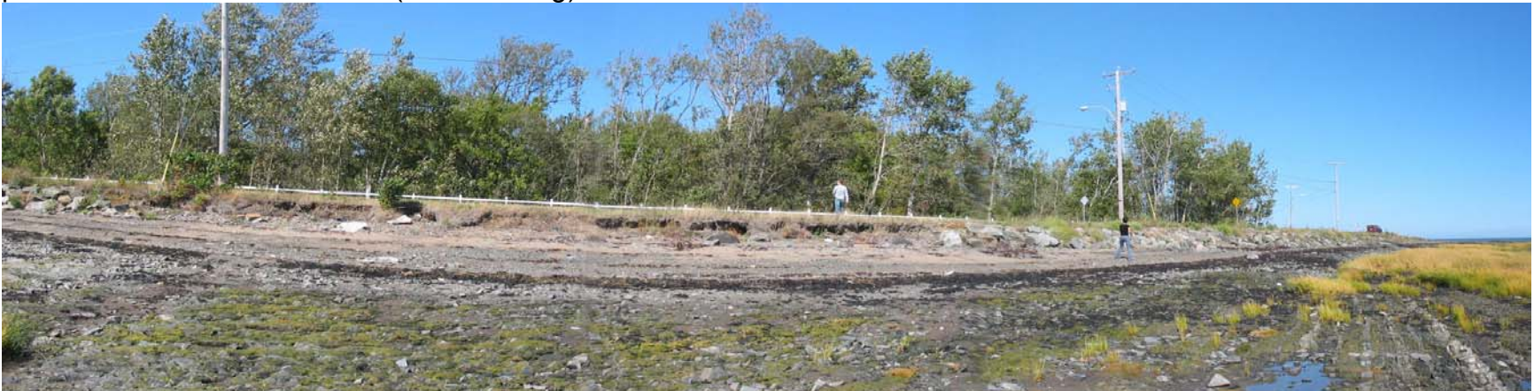
Photo 5 : Secteur non protégé entre les ouvrages en enrochement « 2 » et « 3 ».
