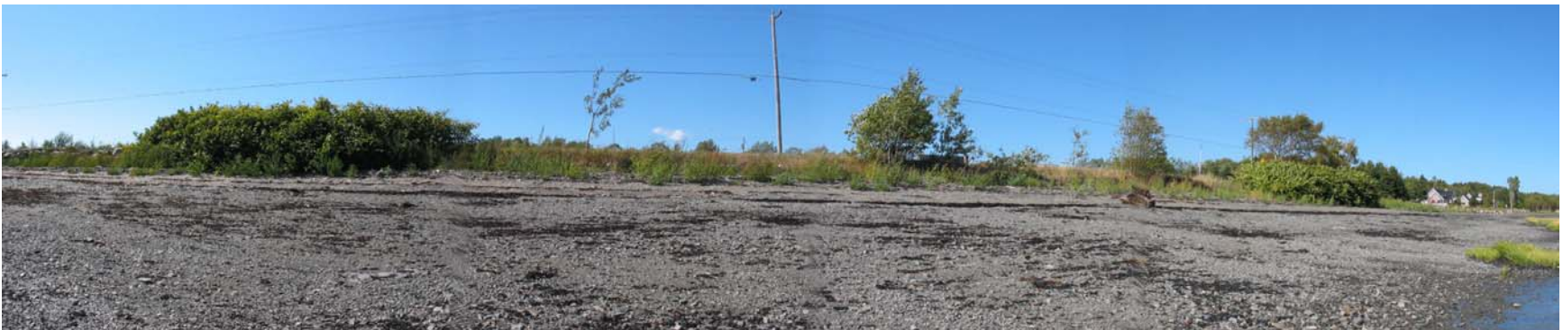
Photo 12 : Secteur non protégé entre les chaînages approximatifs 10+520 et 10+640 où l'érosion est moins agressive.
