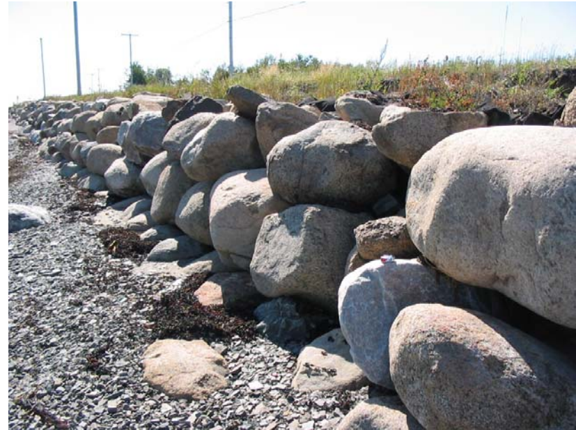
Photo 9 : Les pierres ont été empilées comme pour un muret.
