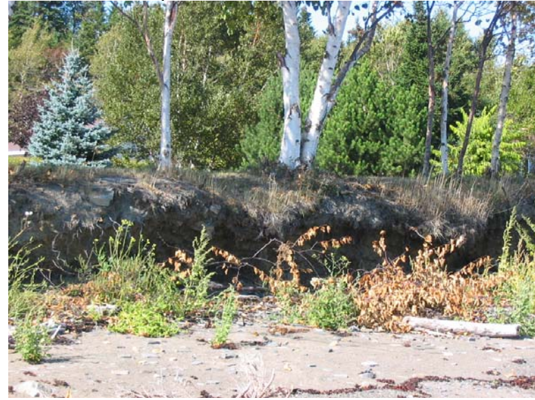
Photo 16 : Érosion plus sévère et arbres en porte-à-faux entre les chaînages 11+180 et 11+560.
