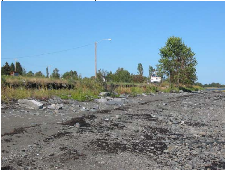
Photo 19 : Érosion plus active entre les ch : 11+740 et 11+860.
