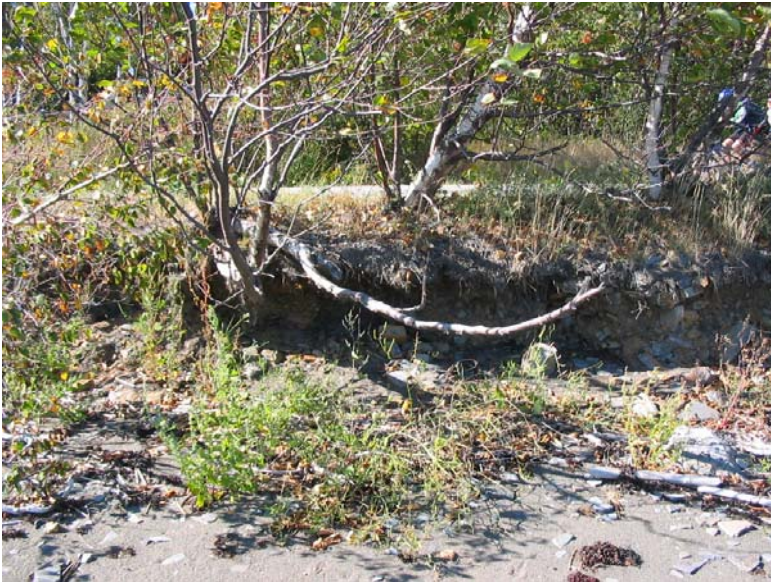
Photo 17 : Arbres en porte-à-faux et remblai très pierreux (ch : 11+180 à 11+560).
