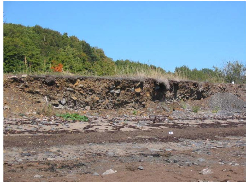
Photo 3 : Remblai de la route en tout venant fortement affecté par l'érosion causée par le déferlement des vagues.
