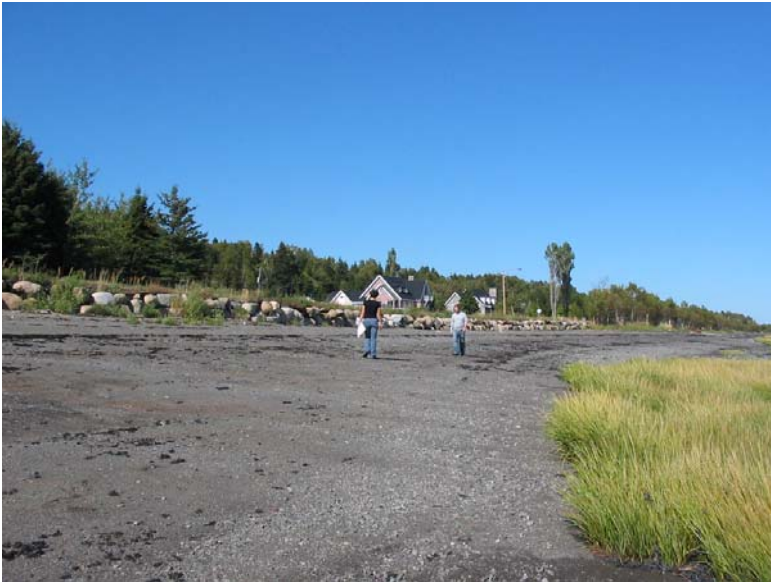
Photo 13 : Autre ouvrage (enrochement « 5 ») réalisé à l'aide de pierres sub-arrondies de calibre 1000-800 mm.
