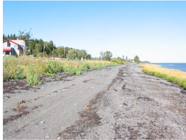
Photo 18 : Érosion moins sévère entre les ch : 11+560 et 11+740.
