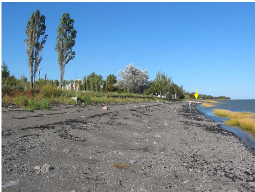
Photo 21 : Érosion plus sévère entre les chaînages approximatifs 12+030 et 12+200. La flèche en jaune indique la localisation de l'épi en pierre
