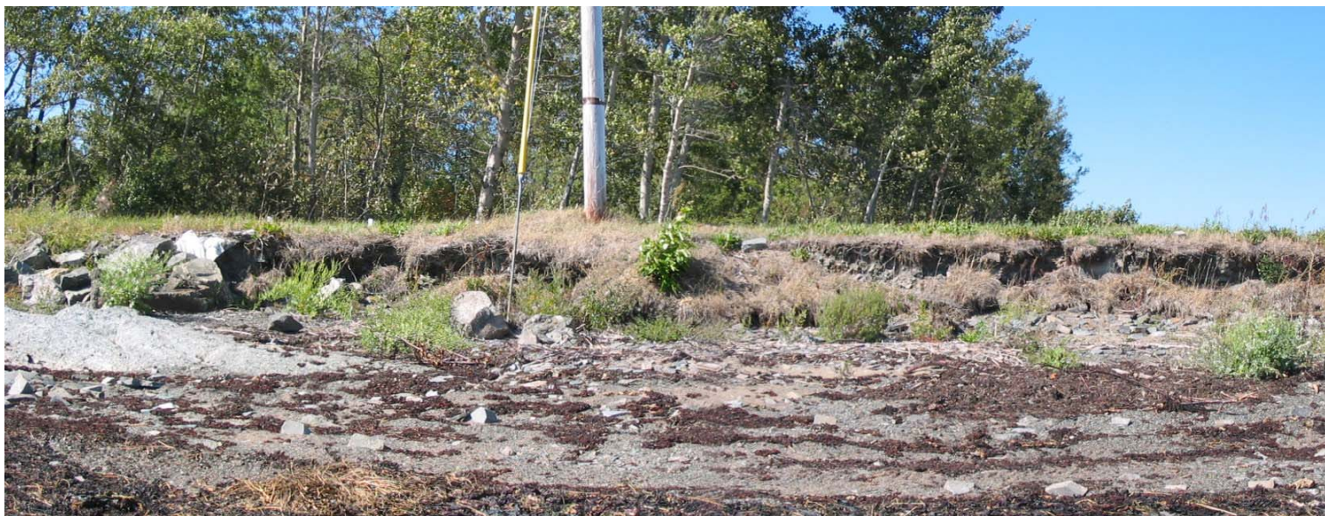
Photo 6 : Effet de bout à l'extrémité est de l'ouvrage en enrochement « 3 ».
