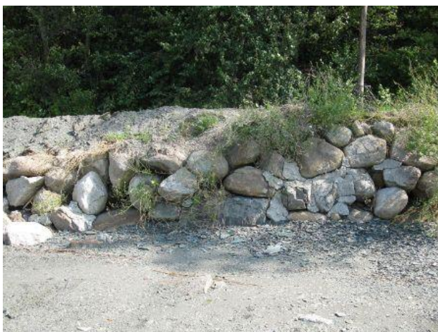
Photo 3 Ajout de matériel sur le chemin des Prairies au-dessus d'un enrochement déficient et étouffement de la végétation terrestre.
