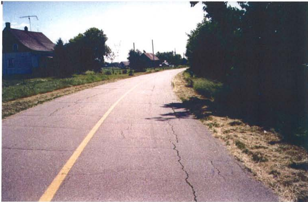
Photo 10 Fissure dans le pavé, le long de la rivière Maskinongé.
