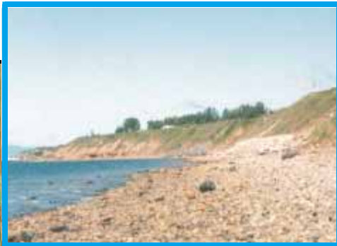
Vue vers l'ouest, falaise de matériaux granulaires marquée de décrochements qui menacent la route 132 sur quelque 540 m. Un empierrement de 100 m en 1997 fut déjà mis en place pour contrer un décrochement.
