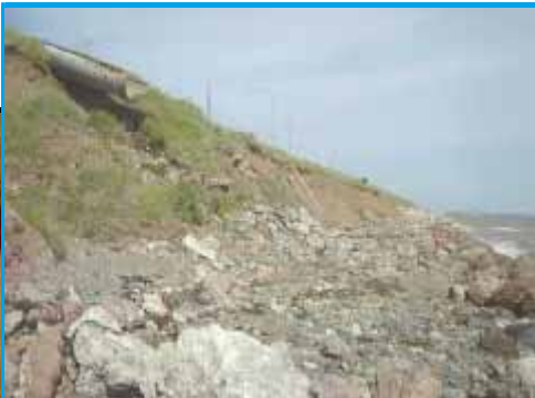
Vue vers l'est, falaise de matériaux granulaires marquée d'une érosion sévère en pied de talus et de décrochements qui menacent la route 132 sur quelque 780 m. Un empierrement de 50 m fut déjà mis en place en 1997 (décret d'urgence) au centre de ce segment de berge.
