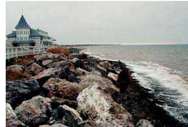
Configuration de la berge à marée haute. À noter l'empiètement et la discordance visuelle de cette protection dans un secteur à vocation touristique.
