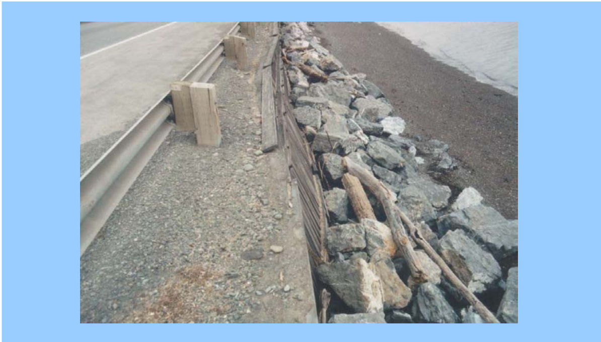
Figure 4 Détérioration avancée du mur dans le secteur du projet
