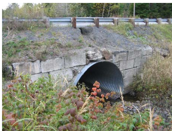
Ouvrage en aval, Rang Saint-Gaspard
