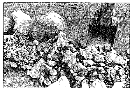
Matériaux hétérogènes déposés derrière les abris de courant
