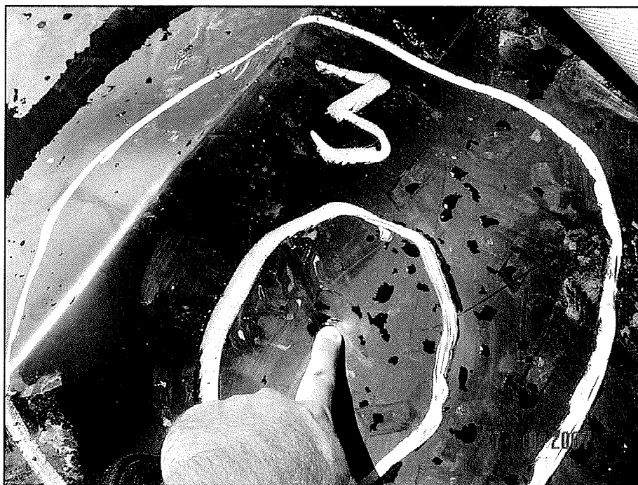
Photo 4 : Perforation F3 détectée au jet d'eau
