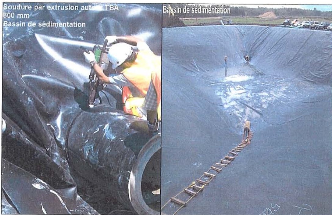
Étanchéisation autour du TBA 600 mm entrant dans le bassin de sédimentation (19 juillet 2006)
