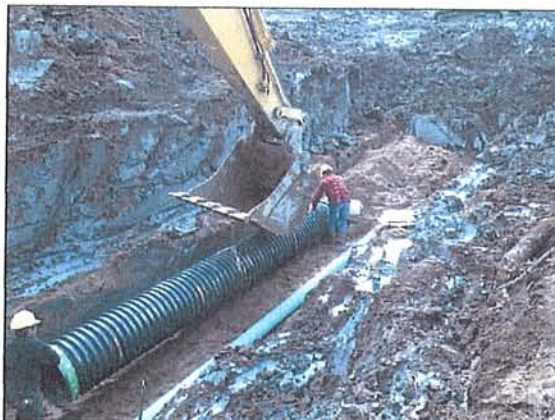
Pose des tuyaux pluviaux (ondulé) et émissaire (PVC) à l'ouest du site – servitude nord des bassins d'aération de la RIMT (12 avril 2005)
