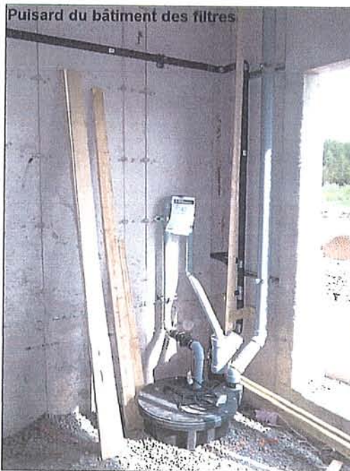
Poste pompage d'eaux usées (égout) vers fosse septique (16 août 06)
