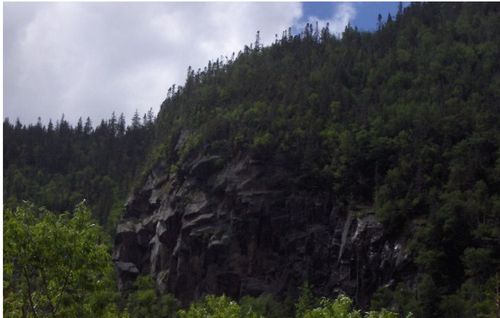
Photo # 6 Falaise du chemin de la vallée de la rivière Brûlé
