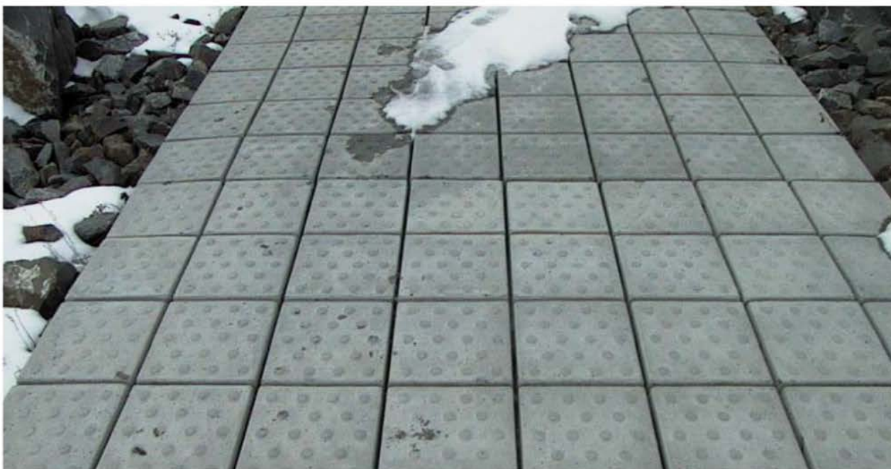
Photo 2.2 Tapis de béton flexible avec blocs de forme cubique
