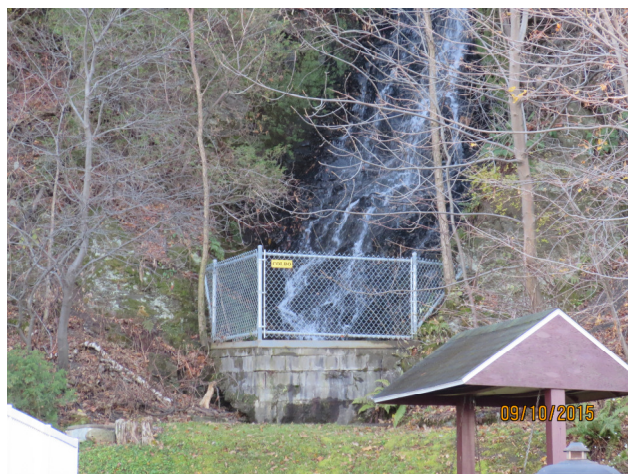
Photographie 2. Section non canalisée de la conduite pluviale localisée entre les lots 3 020 467 et 3 021 342
