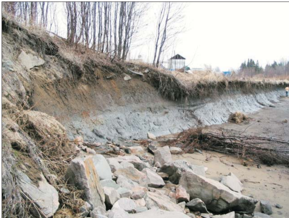
Photo 2. Érosion due en partie à un effet de bout (Rag 8)
