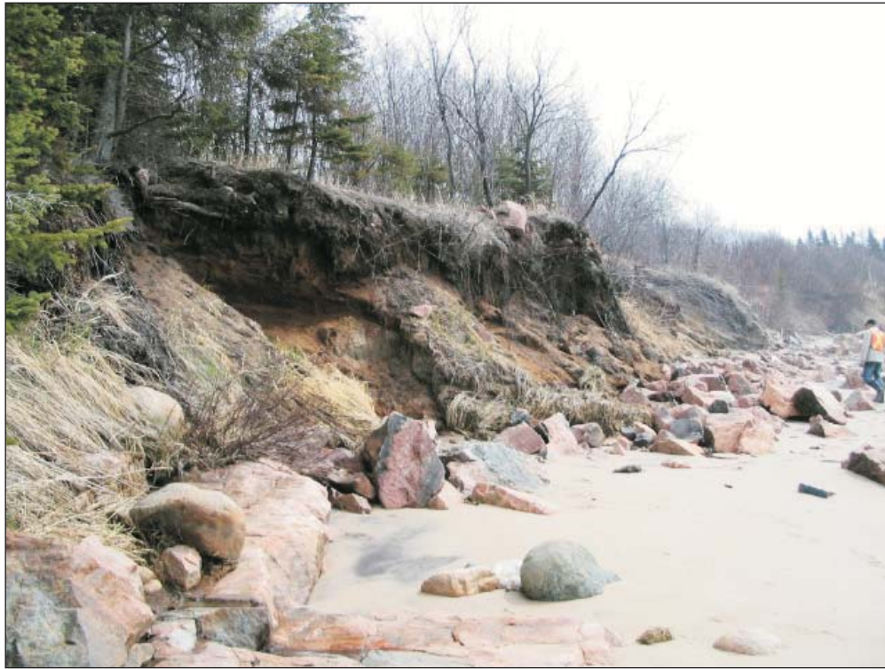
Photo 1. Section d'un ancien enrochement à restaurer (Rag 4)
