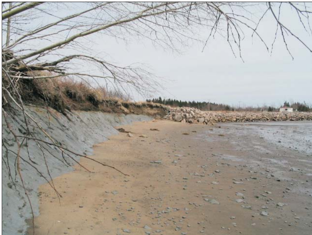
Photo 4. Érosion marine incluant une portion affectée par un effet de bout (Rag 20)
