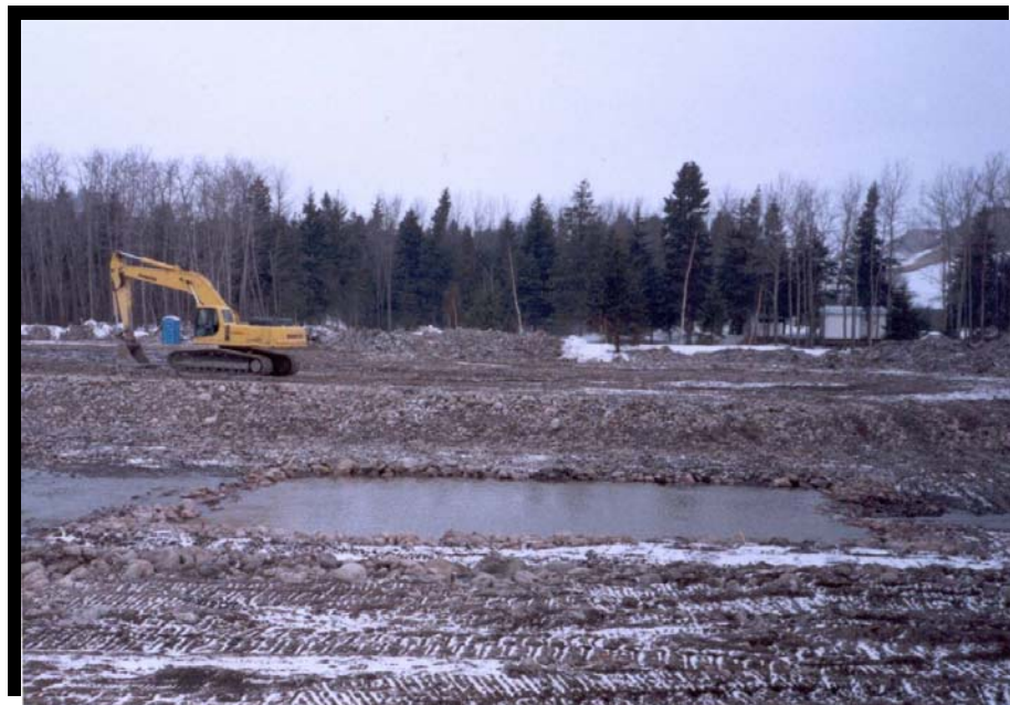
FIGURE 149 Construction d'une fosse à saumons dans la rivière à Mars reconstituée après le déluge des 19 et 20 juillet 1996. La Baie. (1997.1129)
