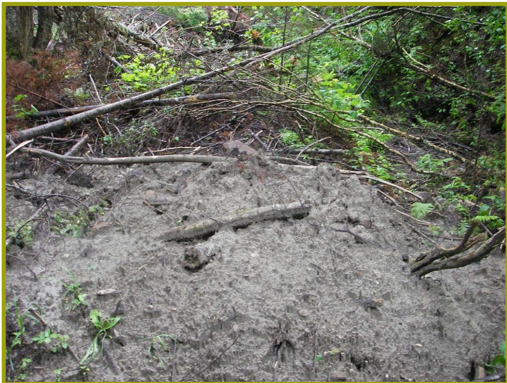
Figure 5.8 Présence d'argiles dans des sols inclinés entre les chaînages 6+000 et 6+880 (chaînage 6+130).
