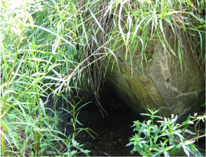
Vu du ponceau de route défectueux à l'est de la route 147.
