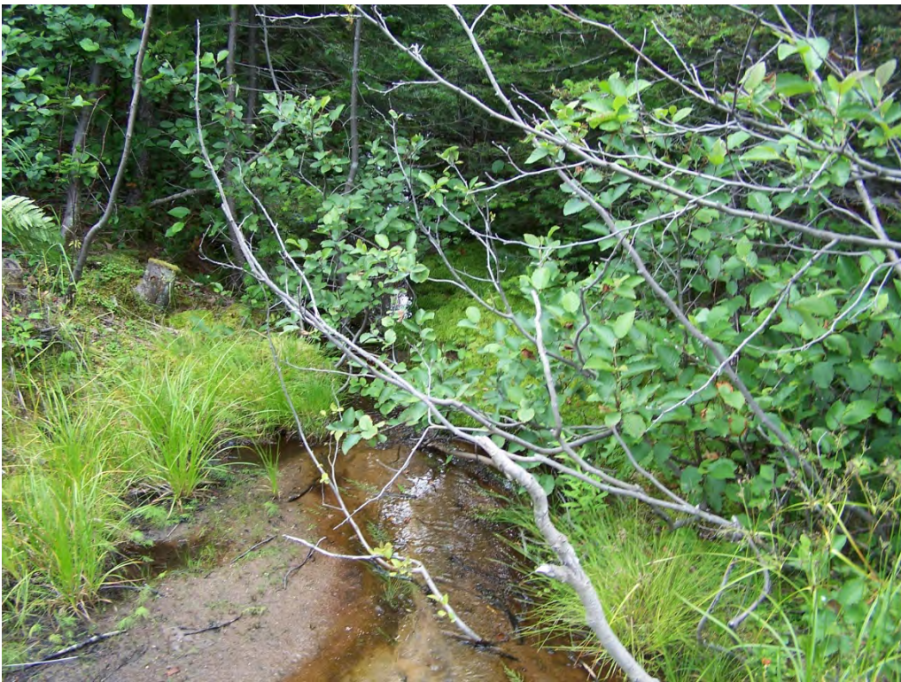
Photo 2 – Dispersion de l'eau du ponceau dans la végétation à l'ouest de la route 138, à la hauteur du chainage 2+265.
