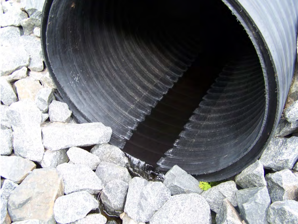
Photo 1 – Sortie du ponceau, côté ouest de la route 138, à la hauteur du chainage 2+265.
