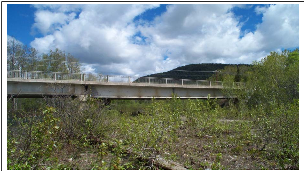
Photo 2 Vue aval de la travée est du pont de la rivière Escuminac.
