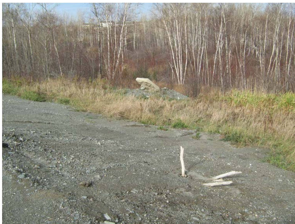
Photo 23 – Prise de vue du terrain naturel, en contrebas, à partir du dessus du monticule, où on observe des débris de béton (chaînage 6+900).
