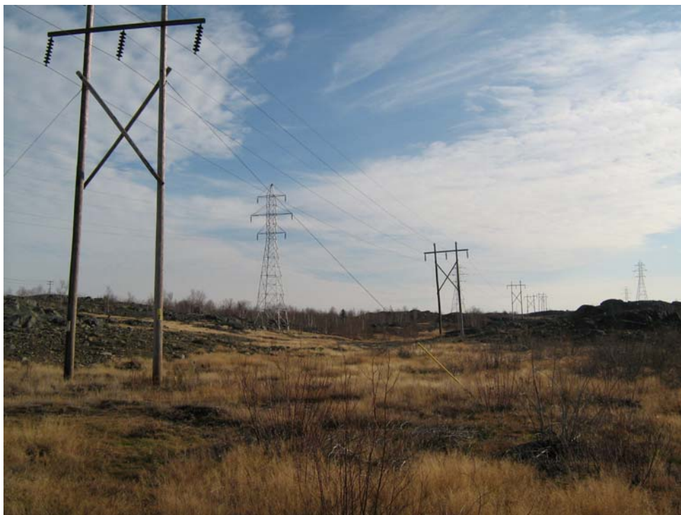
Photo 10 – Prise de vue des installations électriques situées le long du tracé proposé, section correspondant globalement au chaînage 1+000 à 2+500.
