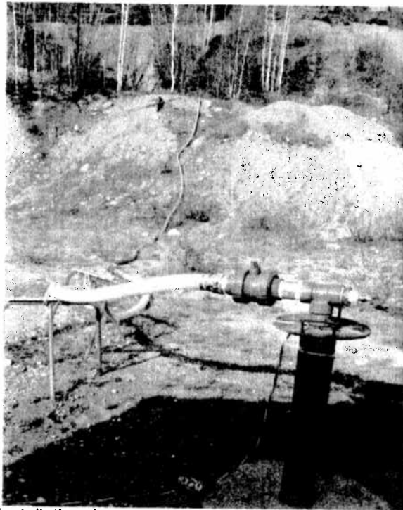
Photo 3. Installation de pompage au FE-7
