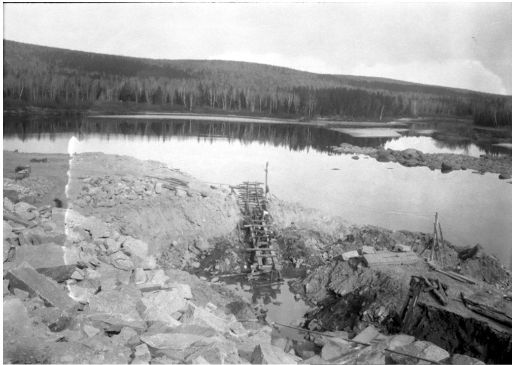
Photo n° 10. Construction d'un chemin de fer traversant la rivière Matawin en aval du barrage (20 septembre 1930; Archives nationales du Québec).
