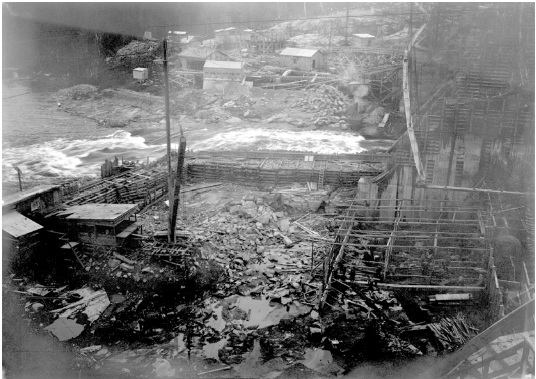
Photo n° 12. Assèchement du lit de la rivière avec un batardeau pour la construction d'un des piliers du barrage (1 er juillet 1930, Archives nationales du Québec).
