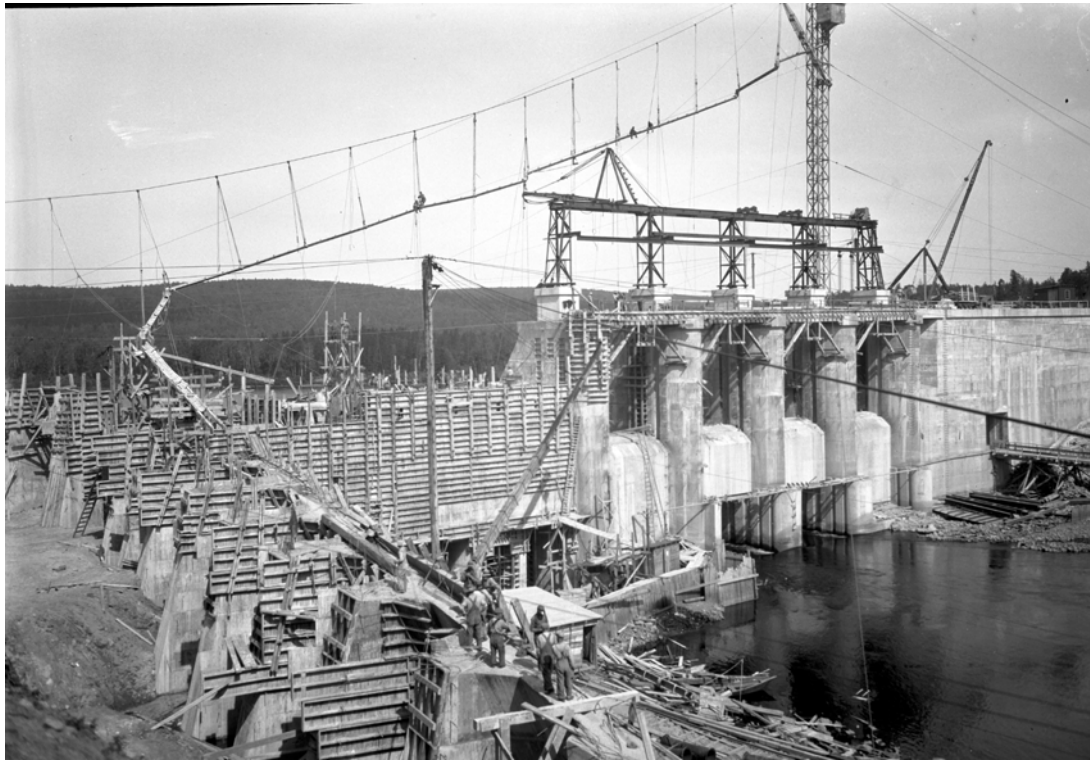
Photo n° 13. Chantier lors de la construction du barrage (20 août 1930; Archives nationales du Québec).
