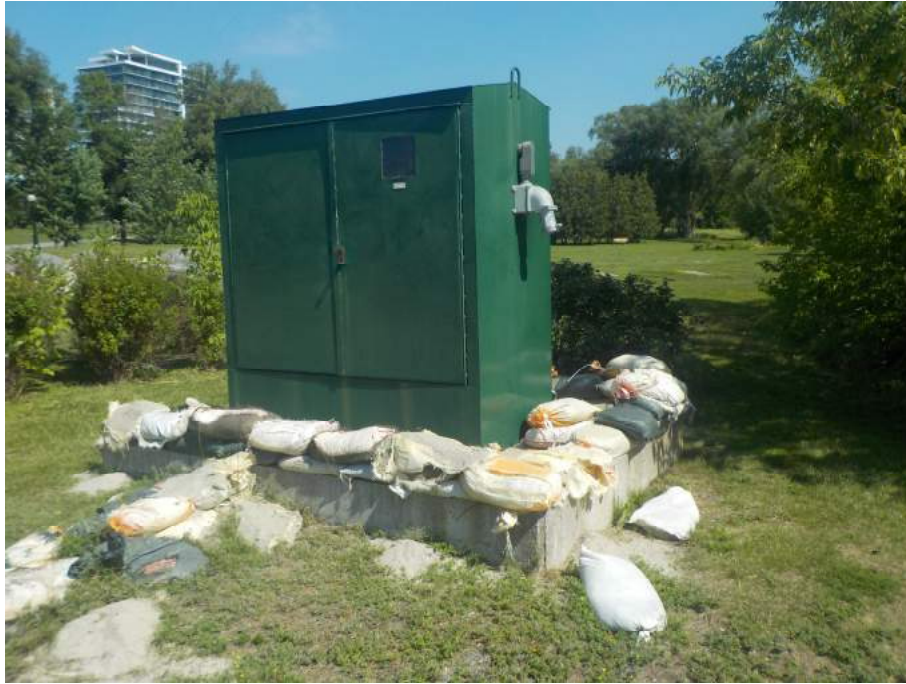
Photographie #11 Vue sur le panneau de distribution électrique en rive Marina de Hull Ville de Gatineau (Québec)
