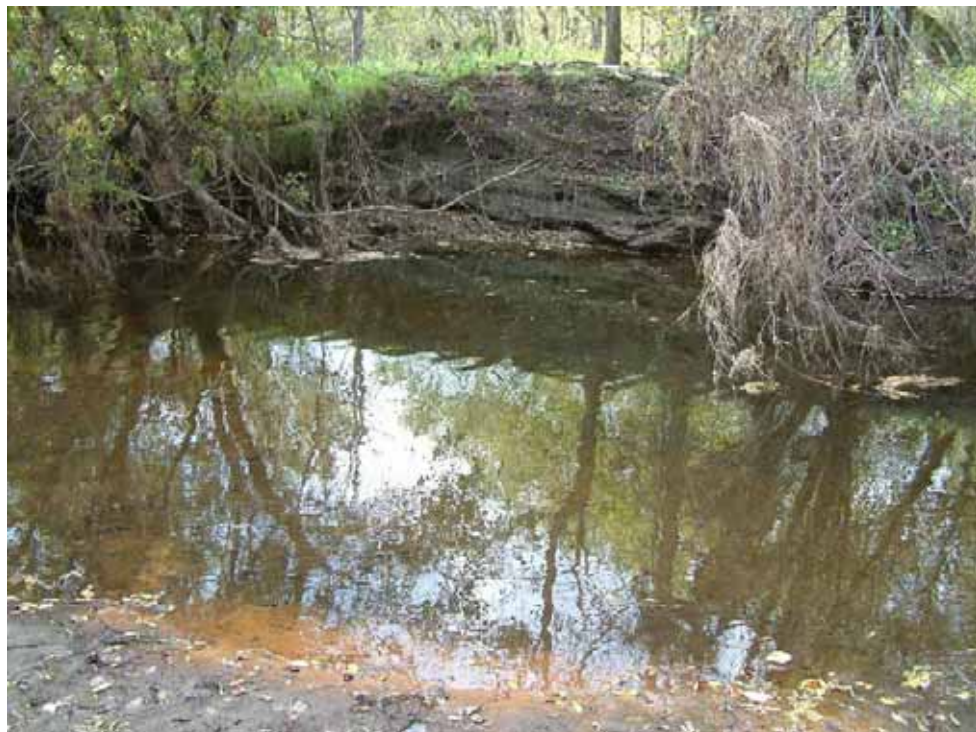
Photo n° 15. Érosion des berges de la station MAW-03
