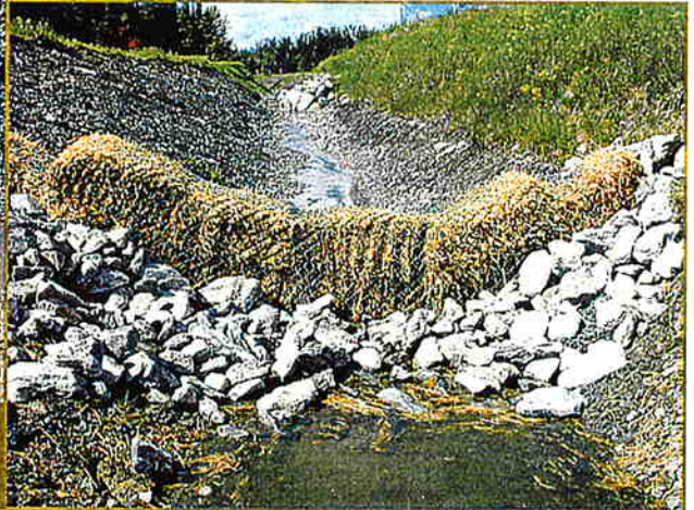
Vue en coupe de l'aménagement d'un muret de pierre et des ballots de paille.
