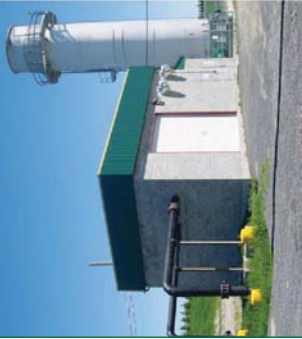
Incinérateur des biogaz
